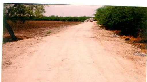
Рис.3. Дорога Райчур-Арснаги через Ядлапур Райчуре, район Карнатака. Дорога с использованием летучей золы (без покрытия). При эксплуатации дороги на протяжении 7 лет проблем не выявлено.
