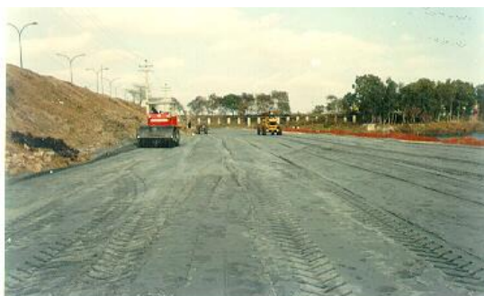
Рис.2. Насыпь дороги при подъезде к мосту Низамуддин в Нью-Дели (в зоне затопления реки Ямуна)
