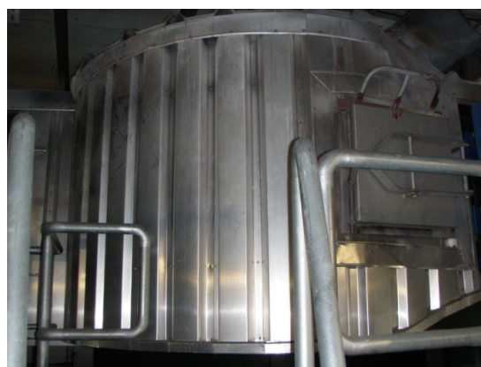
Рис. 2. Часть системы топливоподачи электростанции в Щецине.
