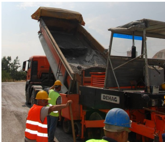
Рис. 3. Налипание свежего бетона на грузовик вследствие транспортной задержки
