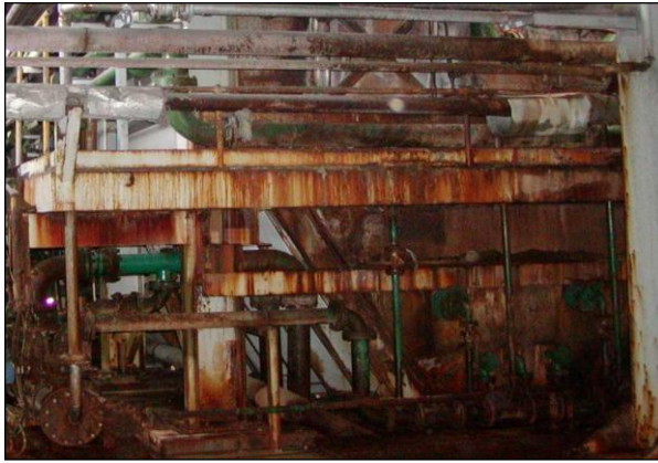
Рис. 7. Коррозия традиционной системы гидрошлакоудаления.
