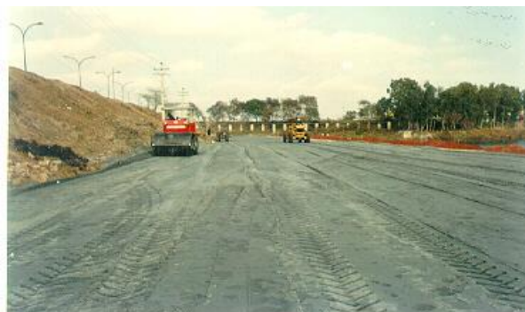
Рис. 1. насыпь подъездной дороги к Низамуддинскому мосту в Нью-Дели (в зоне затопления реки Ямуна)
