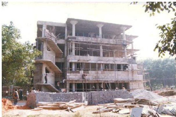
Рис. 4. Здание, построенное с использованием кирпичей из летучей золы в Индийском институте технологий Нью-Дели
